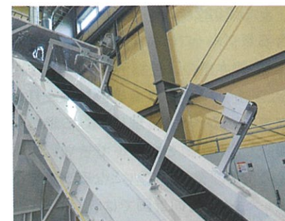
▲コンベアーには火災検知器を設置
